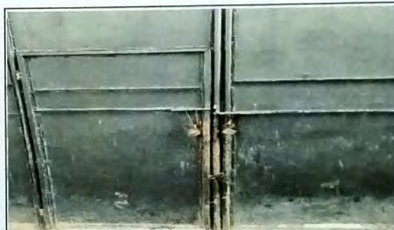
Foto 12: Vista Frontal de Porton sin chapa,
