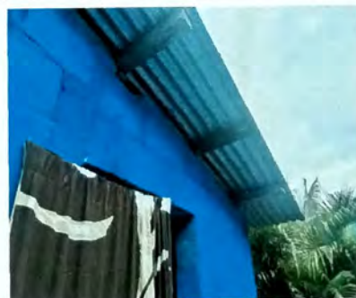
Foto 10: MODULO C SANITARIOS Se Cambiara la estructura portante de madera y lamina de zinc en mal estado por costaneras de metal y lamina troquelada cal 26.
