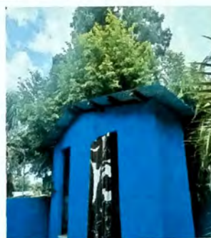
Foto 8: MODULO Vista de servicios sanitarios, se colocara base metalica para colocacion de rotoplast. Se extendra circuito de pvc de 3/4 y se sustituiria bomba de succion existente.
